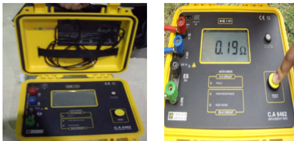
รูปที่ 7 แสดงเครื่องมือวัด Earth & Resistivity Tester และค่าความต้านทานรวมของระบบกราวด์ที่วัดได้หลังการปรับปรุง
